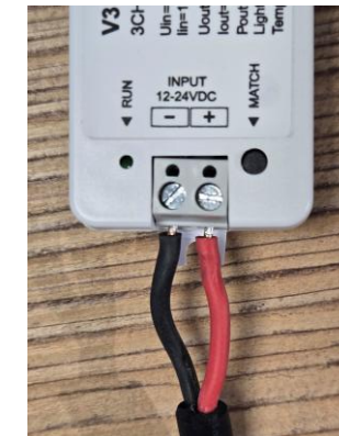
Départ du contrôleur RGB vers le transformate ur 24v
